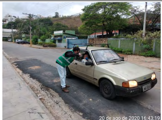
Foto 12 – Apoio no bloqueio de vias para o desmonte de rocha – Rua Padre Francisco Salvino. (20/08/2020)
