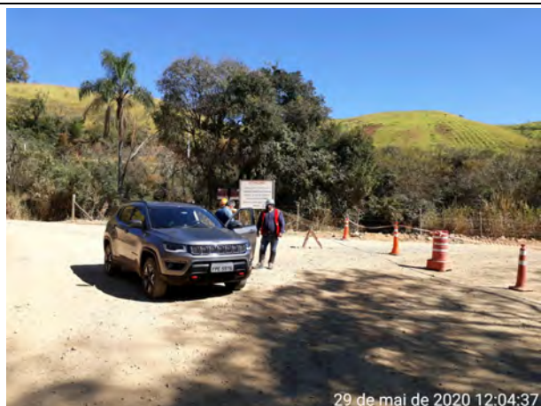
Foto 8 – Apoio no bloqueio da atividade de desmonte de rocha na ponte Pedreira – Sousas (29/05/20).
