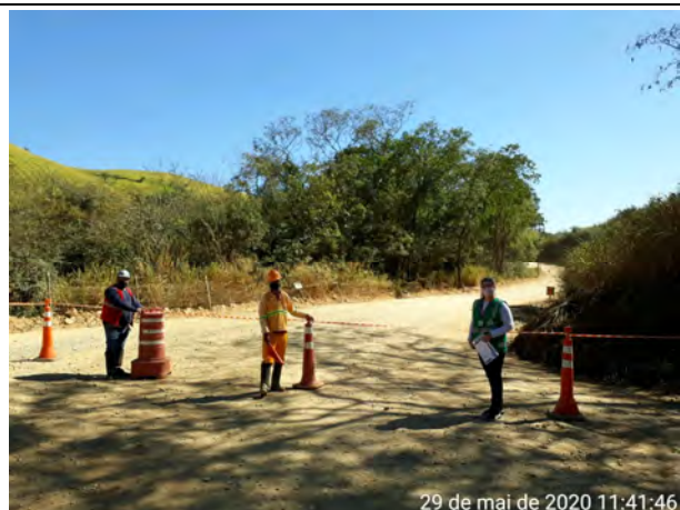
Foto 7 – Apoio no bloqueio da atividade de desmonte de rocha na ponte Pedreira – Sousas (29/05/20).
